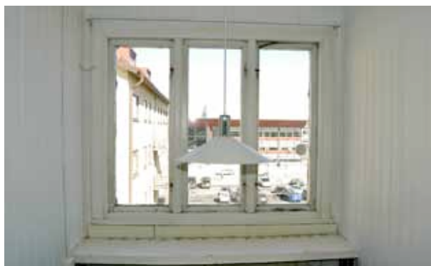
Den till stor del intakta lägenheten på vindsplanet har väggar i pärlspont och välbevarade fönstersnickerier. Foto 2007-04-24
