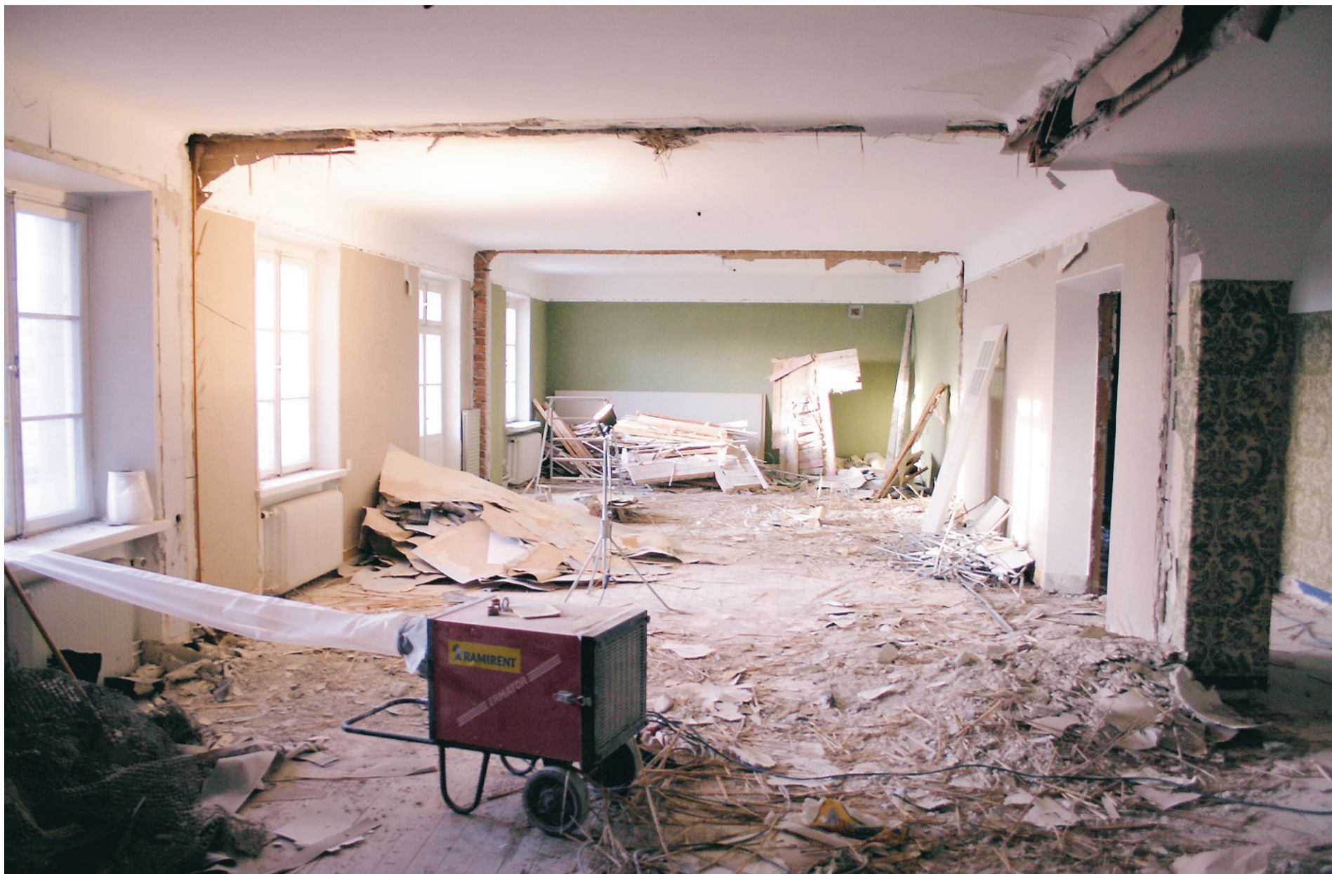
20-talshuset i Karlstad hade välbevarade paradlägenheter, med påkostade blyinfattade dörrar. Nu är all originalinredning borta. Även de spröjsade fönstren ska bort.
